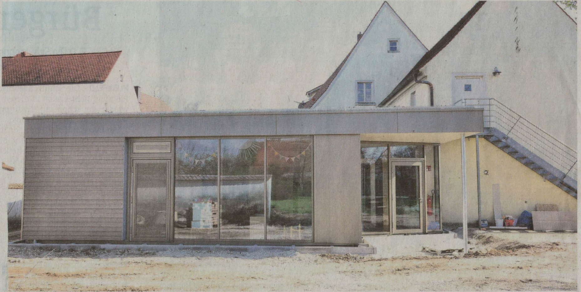
In Holzbauweise wurde die Kindertagesstätte in Trommetsheim erweitert. Dort können nun 25 Mädchen und Jungen ab drei Jahren und zwölf Krippenkinder ab einem Jahr betreut werden. Die feierliche Einweihung ist für den 3. August geplant. Foto: Rainer Heubeck
