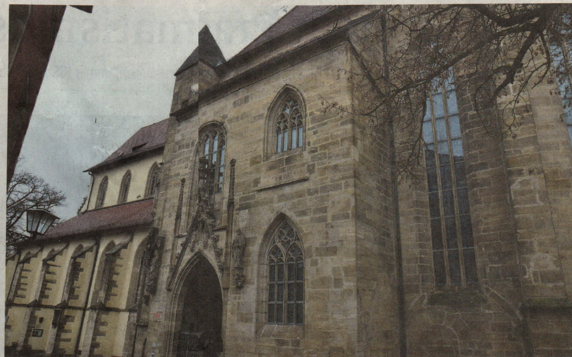
Die Südfassade der Stadtkirche St. Andreas muss in einem weiteren Bauabschnitt saniert werden. Der kleine Turm und das Brautportal wurden mittlerweile gesichert. Foto: Rainer Heubeck
