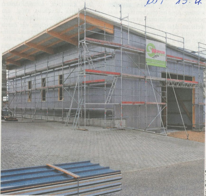
Der erste Handwerker Gottesdienst in der Reihe „Kirche mit Leib und Seele“ findet in Oberhochstatt in der neuen Halle von Holzbau Schmoll, die gerade entsteht, am Sonntag, 30. April, ab 18 Uhr statt.
