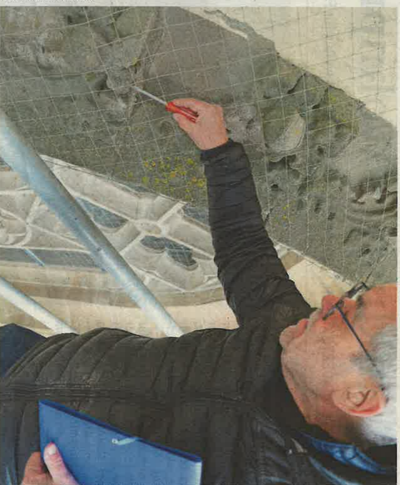
Wetter, Wind und Regen: Die Ornamente um die gotischen Kirchenfenster haben im Lauf der Zeit teilweise sehr gelitten, wie Architekt Arndt am Detail zeigt.
